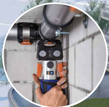
Sistemi di adduzione e riscaldamento
